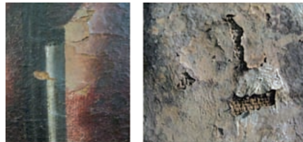
Dissesti e cadute di colore verificatisi in prossimità di vecchie stucature.
